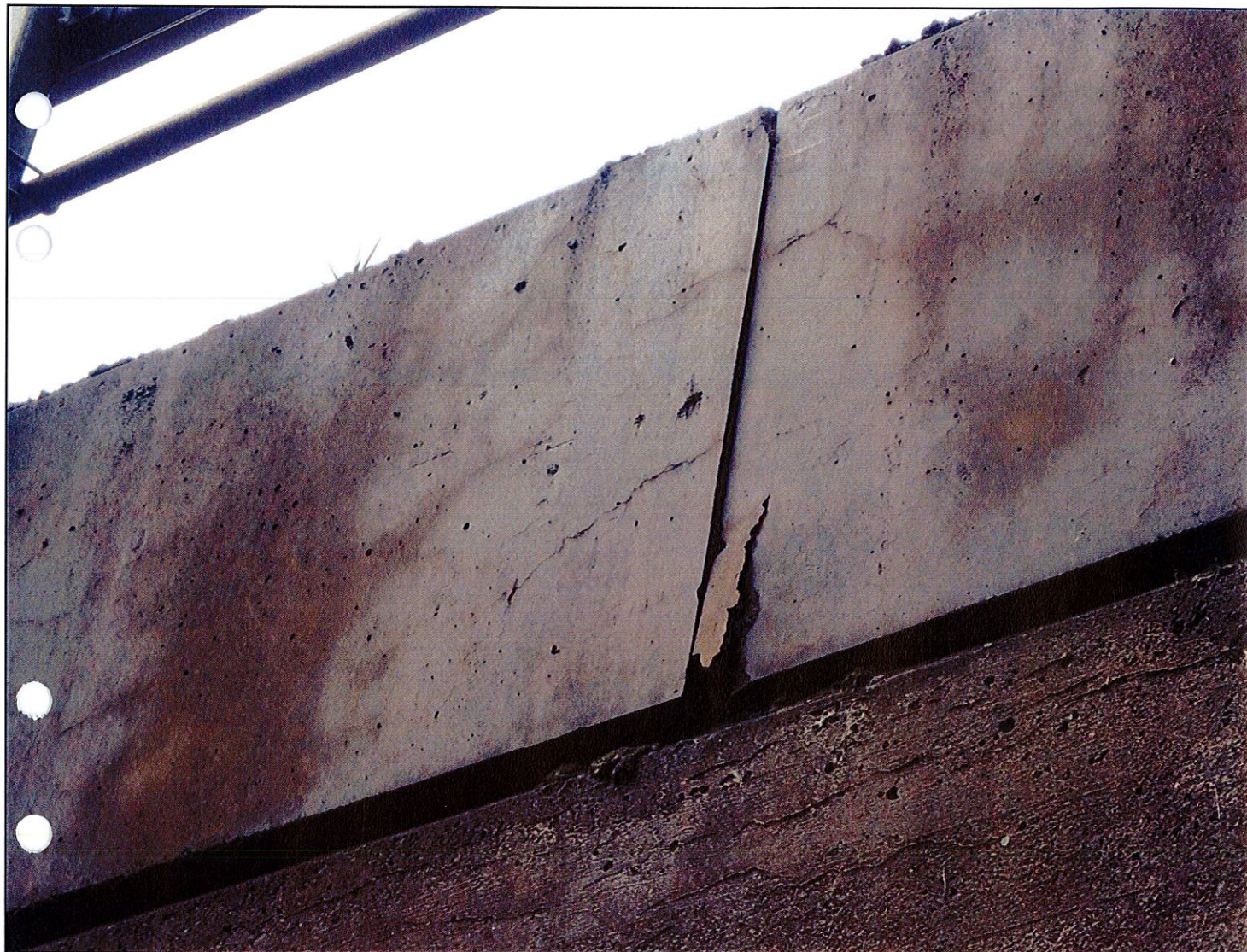
5 - Kantbalk - Armerad betong - Krackelering 2016-10-06
