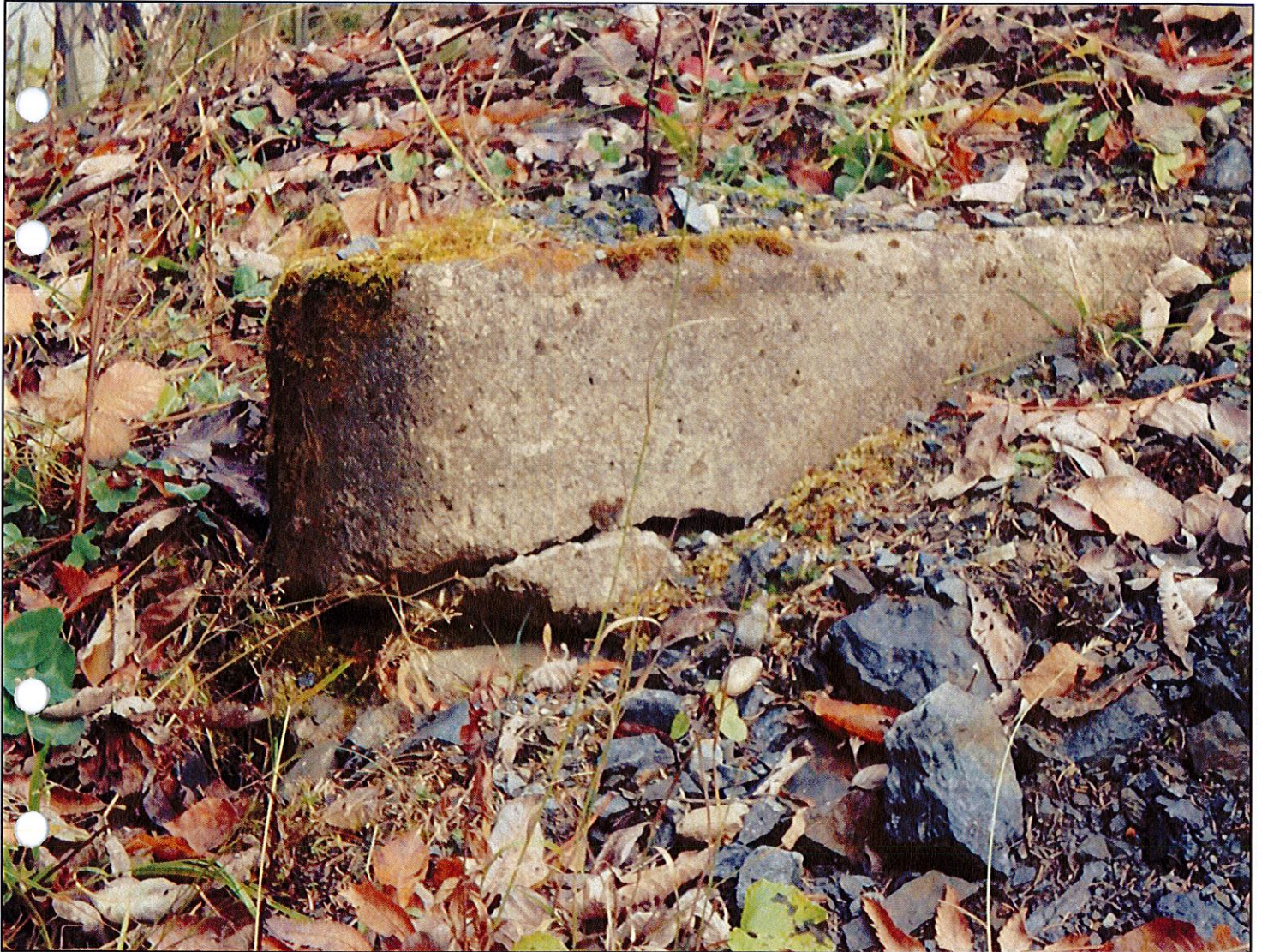
1 - Övrigt - Armerad betong - Rörelse 2016-10-06
