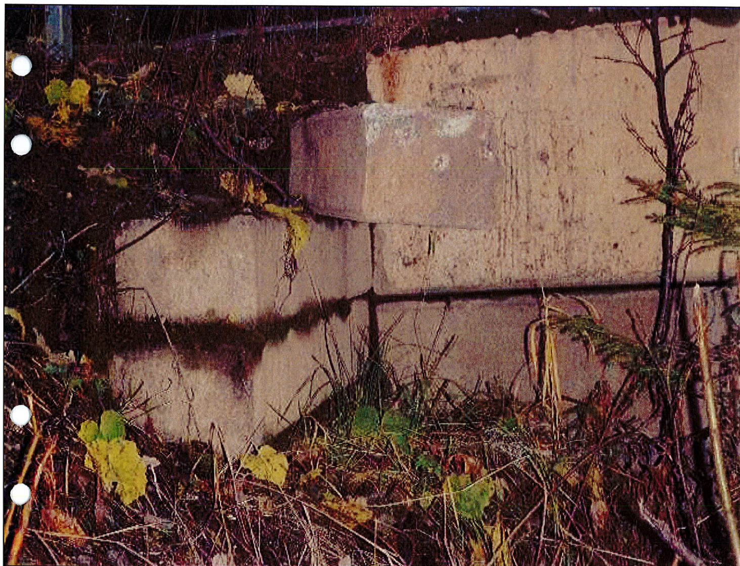
1 - Övrigt - Armerad betong - Rörelse 2010-10-12
