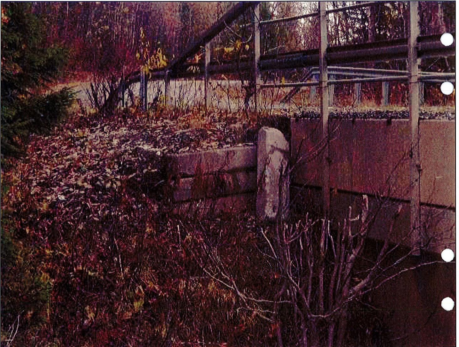
1 - Övrigt - Armerad betong - Rörelse 2010-10-12
