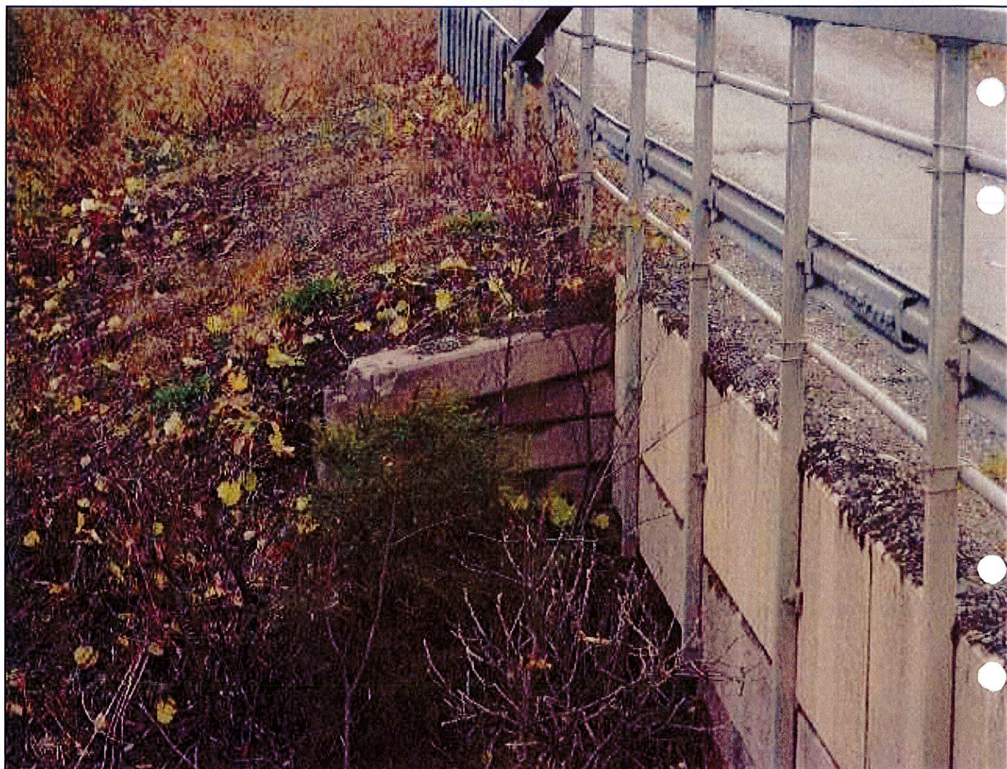
1 - Övrigt - Armerad betong - Rörelse 2010-10-12
